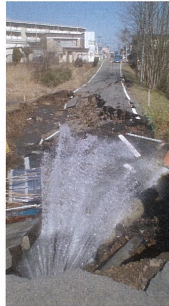
水道管の漏水被害
