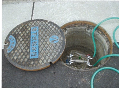
【地下式給水栓】
