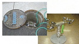
【地下式給水栓】
