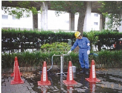
【消火栓型(職員が仮設給水栓を設置して給水)】
