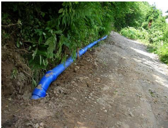
仮設配管(ポリエチレン管)
