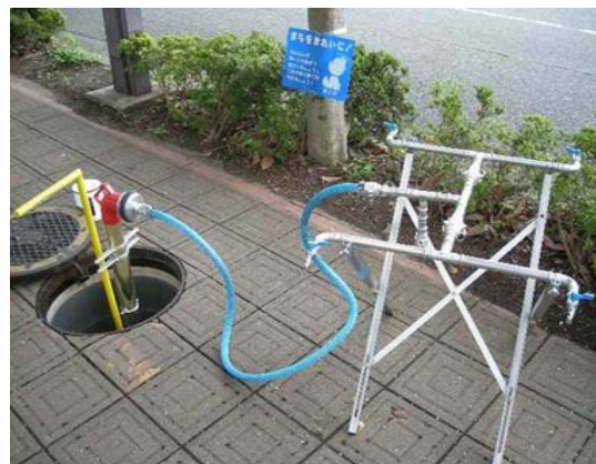
消火栓からの仮設給水栓 図 応急給水の例
