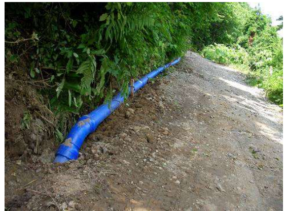
仮設配管(ポリエチレン管)
