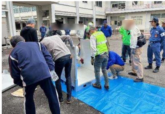
防災対策課・自治区による給水コンテナ設置
