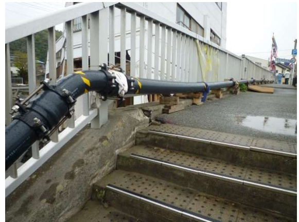
仮設配管(硬質塩化ビニル管)
