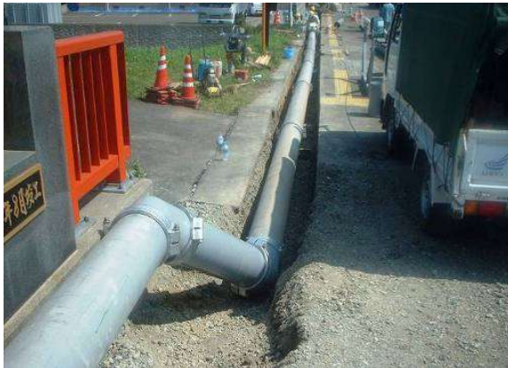
仮設配管(ステンレス管)
