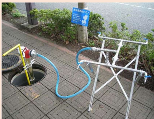
消火栓からの仮設給水栓
