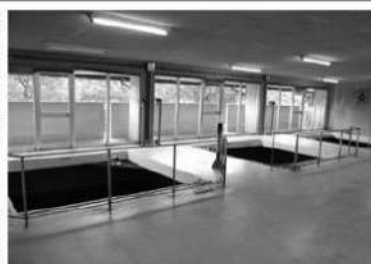
樽ヶ沢浄水場の急速ろ過池
