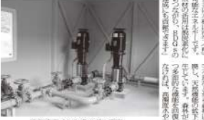
昨年年度完成した送水ポンプ室
