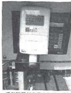
通信機器が内蔵されている表示器を設置
