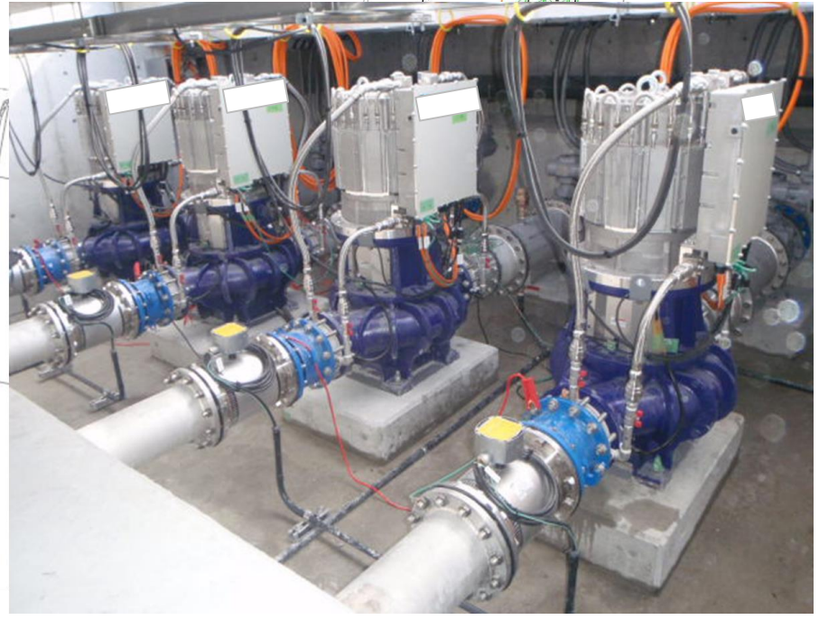
ピット内写真 (75kWクラスの水車、4台並列)
