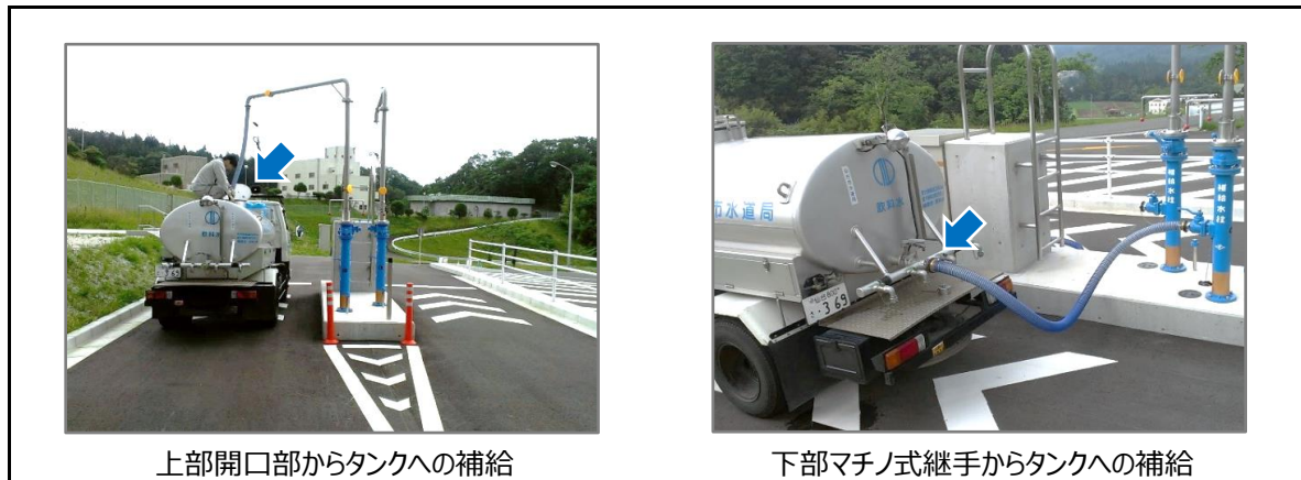
図2 給水車用の飲料水補給設備
