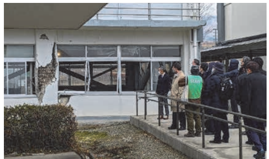
地震による外壁の亀裂等
