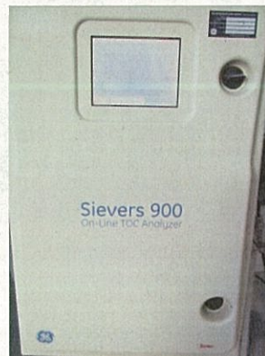
RO処理水のTOC計
