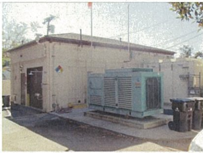
配水池に隣接する追加塩素施設（塩素のみ）
