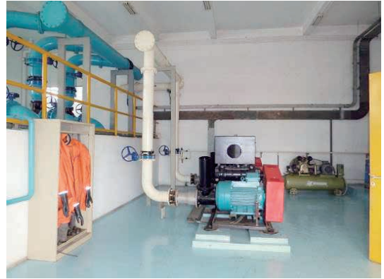
汚過池空洗ブロー
