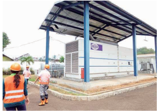
自家発電設備
