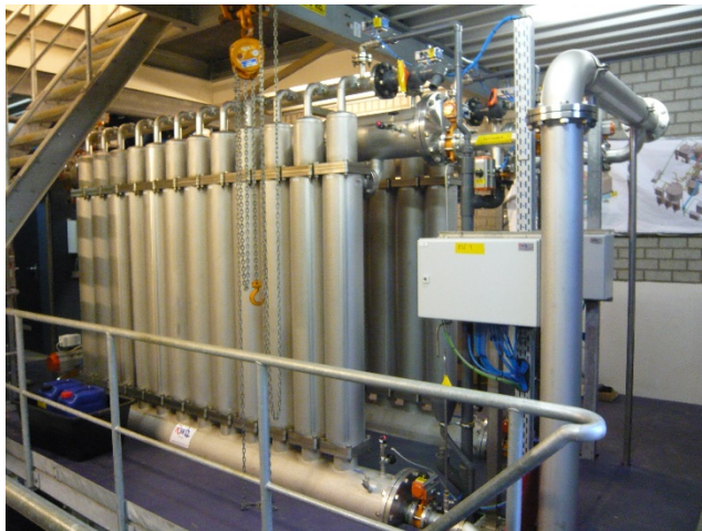
<逆洗排水処理設備>
