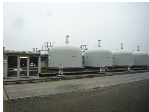
<BAC (生物活性炭処理) 槽>
