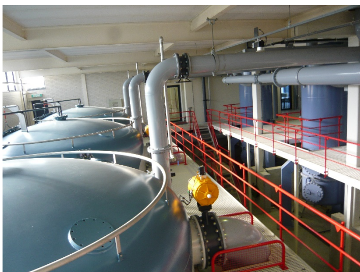
<浄水場内 左：砂ろ過装置、右奥：軟化処理装置>
