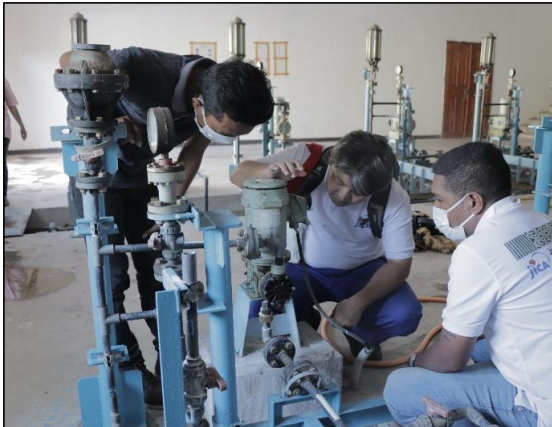
薬注ポンプ故障の調査状況
