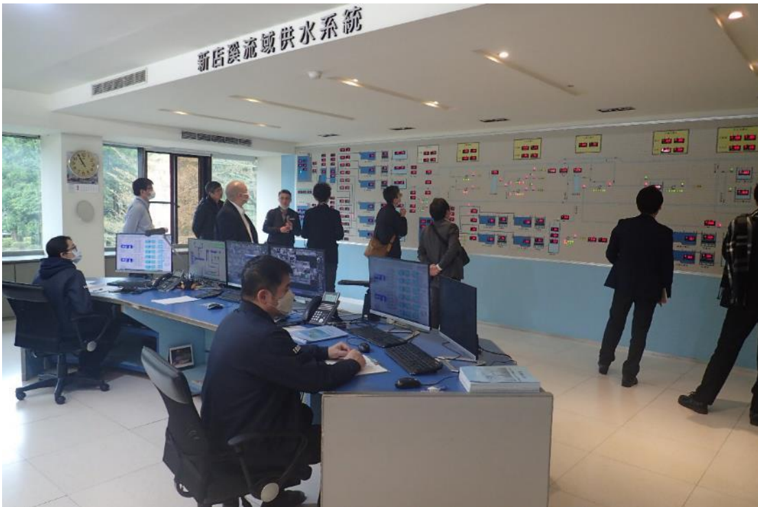
管理室の様子。手前にパソコンを用いたモニタリングシステム、壁面には制御盤流量や水質計器の計測値などが取水～給水先まで系統立ててわかるようになっている制御パネル。
