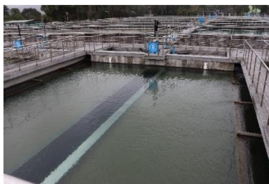
運用状態のろ過池
