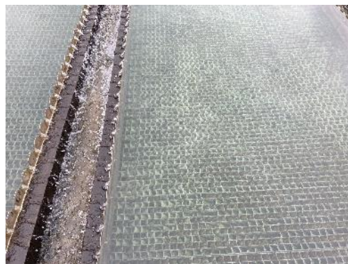
沈澱池の傾斜管
