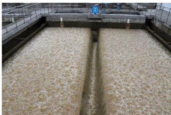
洗浄中のろ過池
