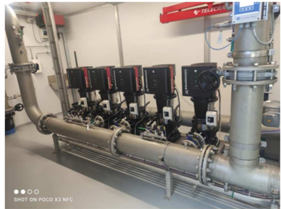
写真9 コペンハーゲン市内の配水ポンプ場
