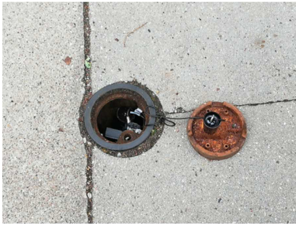
写真 11 漏水検知ロガー
