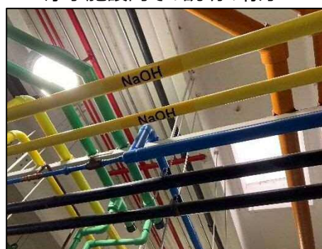
配管写真②
