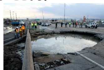
図-33 大規模漏水による陥没
