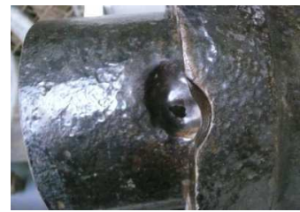
図-34 わずかに破損した水道管
