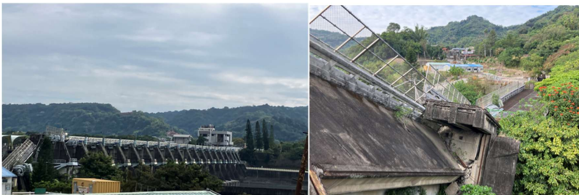
図 13 石岡ダム全景と崩落箇所
