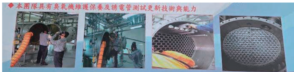
オゾン発生器の誘導体のメンテナンス
