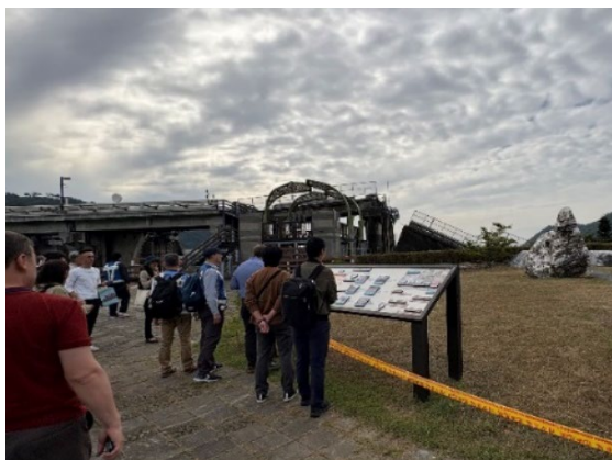
写真2.5.3 断層のずれにより破壊した堤体
