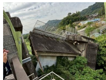
図 5-37 石岡ダム（921大地震被害跡）
