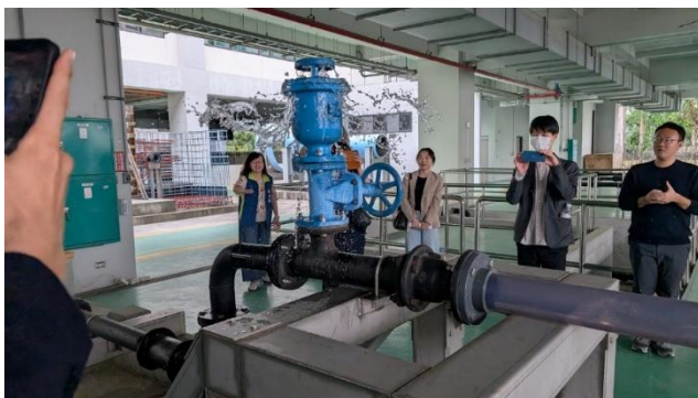
写真-15 バルブ操作研修設備
