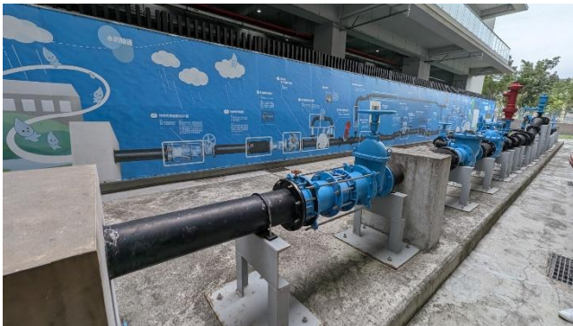
写真-13 配管模型
