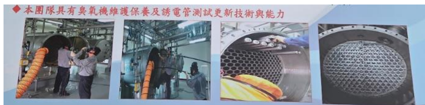
写真-3 オゾン発生器の誘導体のメンテナンス
