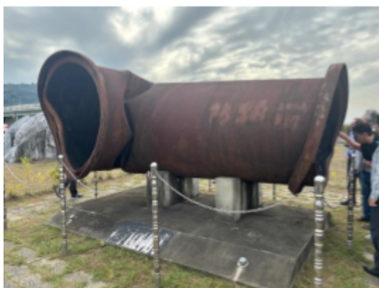
図17 断層により変形した鋼管
