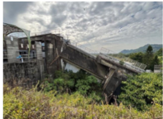
図18 断層により崩壊したダム
