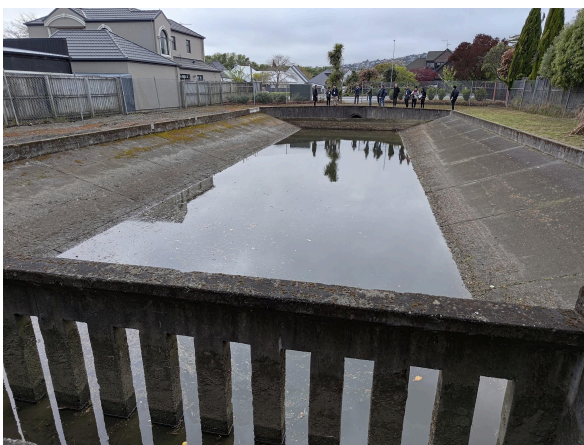
写真15 – Penruddock Rise調整池
