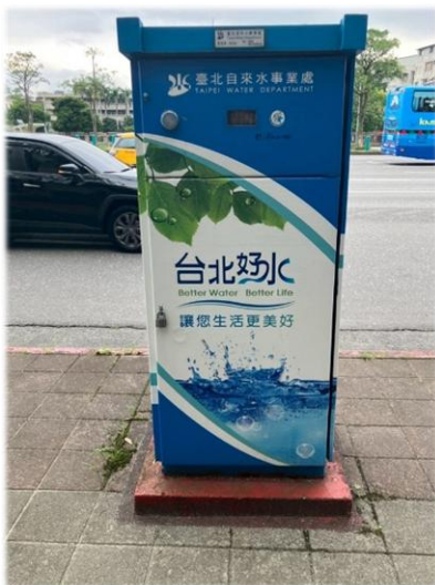
写真 9 監視制御装置
