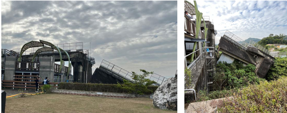
図 16. 地表変位によるダムの破損
