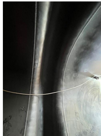
図 20. SPF 配管の座屈変位を 吸収する部分の裏側
