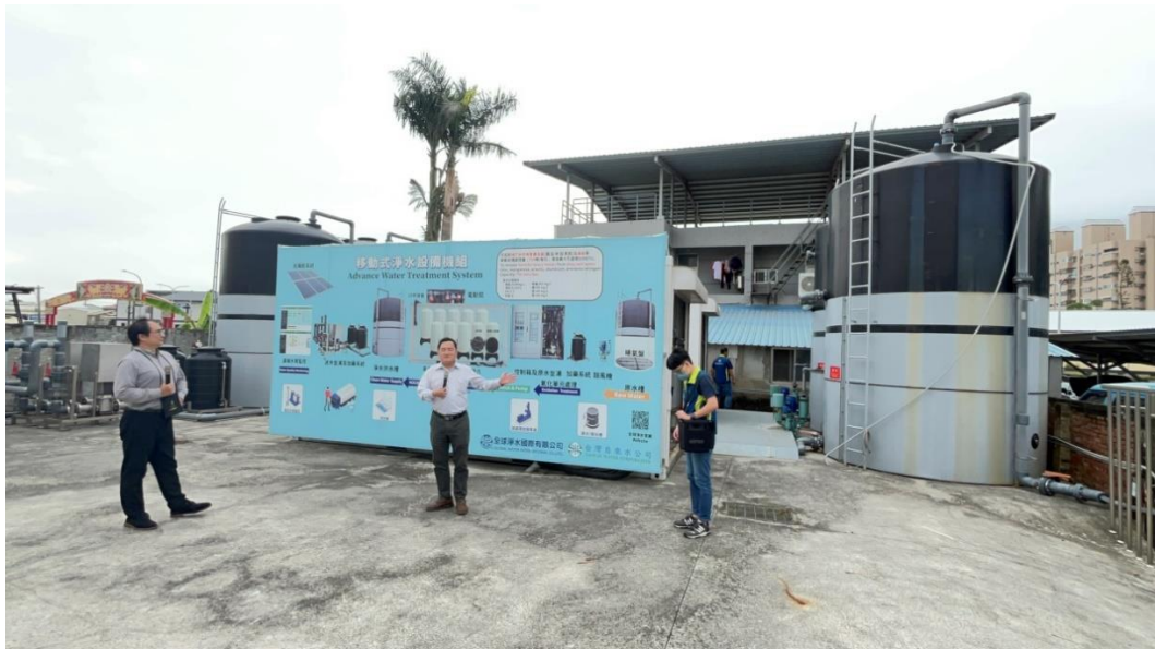
図 10. 緊急用浄水設備
