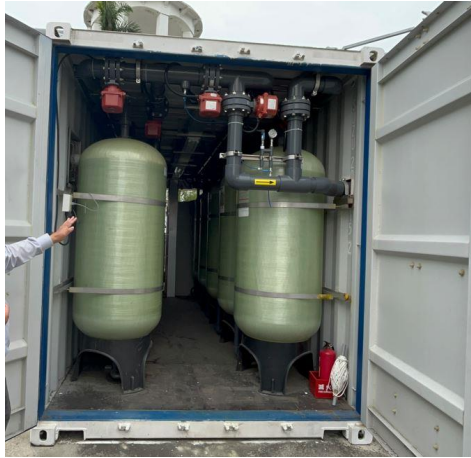
図 11. 緊急用浄水設備（ろ過装置）
