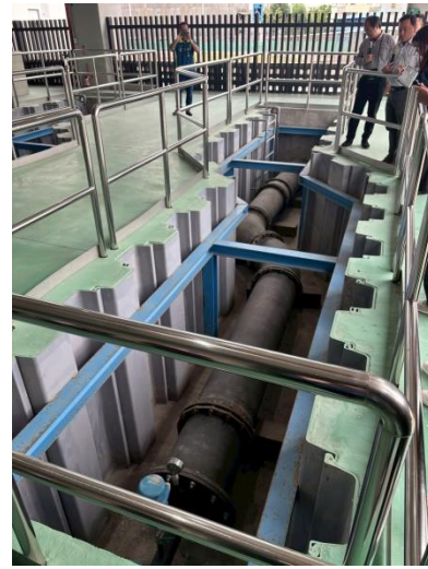
図6. 口径 500mm 配管の実習設備
