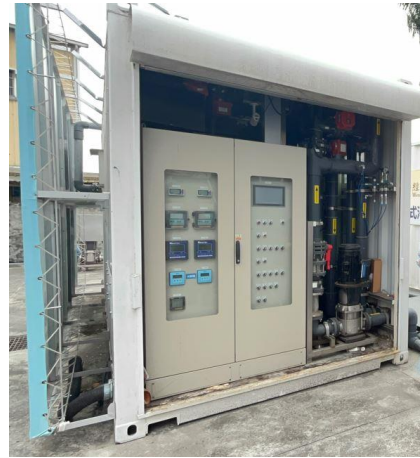
図 12. 緊急用浄水設備（制御盤）
